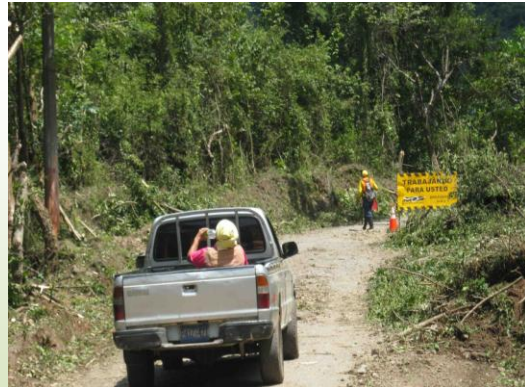
Actividades de limpieza y desmonte, además se observaron rótulos informativos del tramo en construcción. (FOTO de FUNDE)
