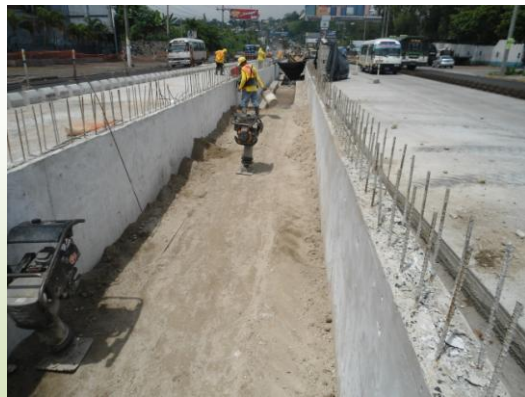
Bases para la construcción de la parada de buses. (Foto de FUNDE)
