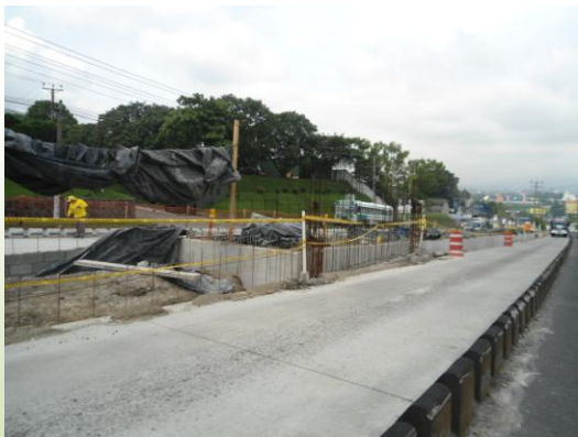
Bases para la construcción de la parada de buses. (Foto de FUNDE)
