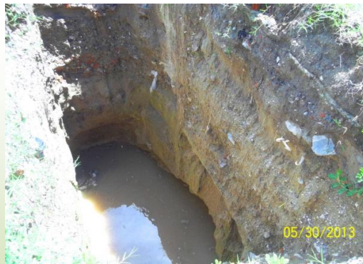
Las excavaciones realizadas para los análisis de suelo delataban la profundidad a la cual se encuentra el suelo contaminado con ripio. (Foto de FUNDE)
