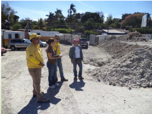
Personal de la empresa constructora y supervisora brindan información sobre las acciones que se desarrollan en el área. (Foto de FUNDE)
