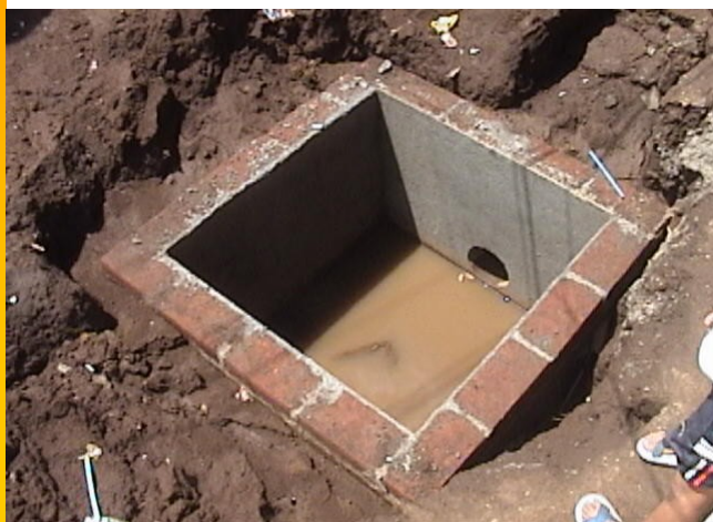
Colector de Aguas Negras
