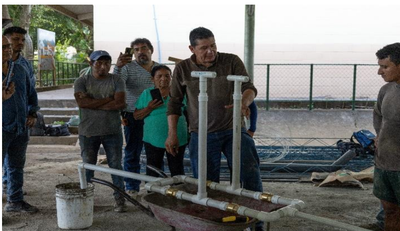
Carlos Rugamas de FUNDE muestra la bomba de extracción de agua que se usa en cisternas que ha instalado FUNDE
