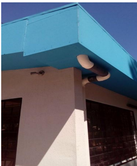
Imagen No. 20. Este proyecto tiene algunas fallas ya que no posee servicio de agua potable ni energía eléctrica, esto no fue incluido en la formulación por lo tanto el constructor, empresa Consolidada de la Paz, S.A. de C.V., no lo efectuó. El día de la visita el presidente de la Junta Directiva de la colonia manifestó “que los vecinos no la utilizan por no contar con los mencionados servicios, lo cual podría considerarse un error de formulación del proyecto”.
