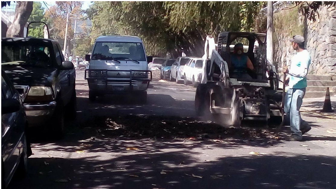
Imagen No. 28. Se observa el trabajo de fresado 9 en la misma calle.
