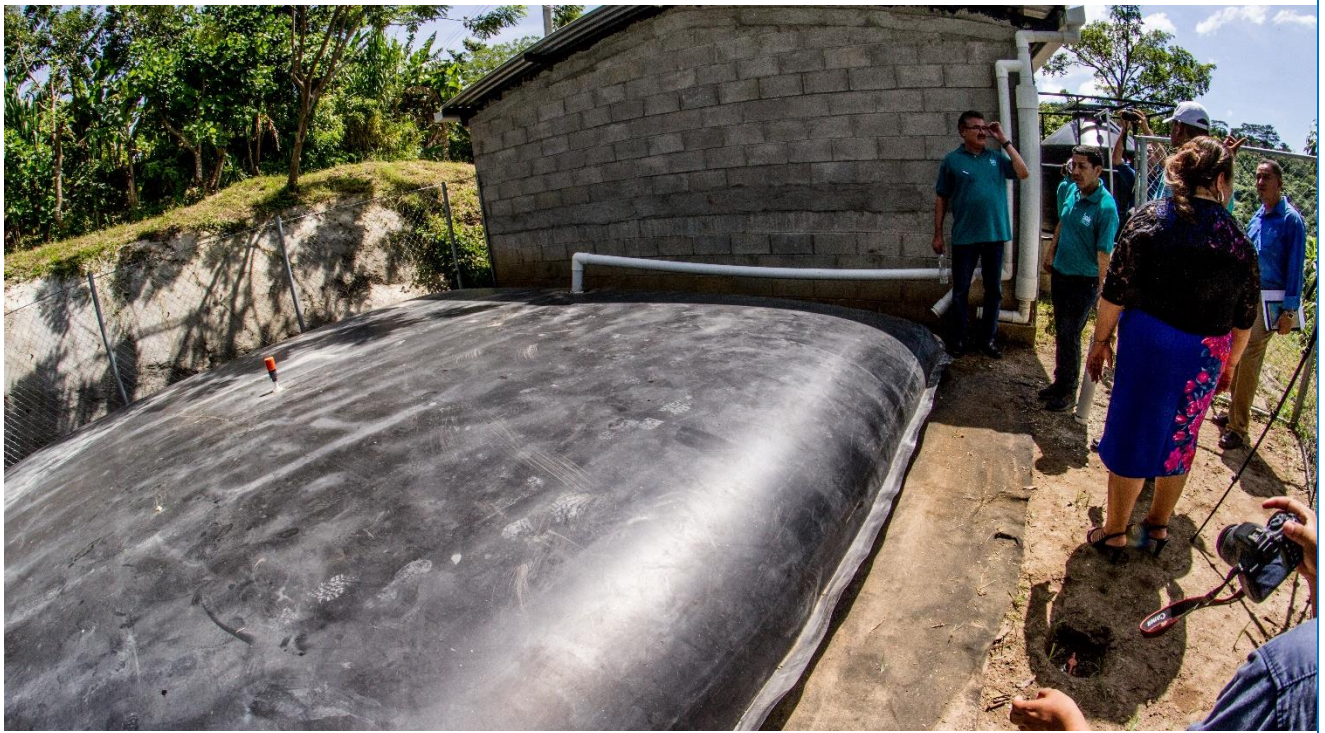
Sistema de Cosecha de Agua Lluvia de Bolsa Geomembrana.
