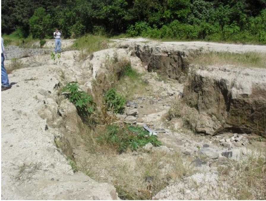
Área deteriorada en uno de los extremos de la sección 1.
